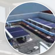
Panneaux solaires pour eau chaude sanitaire
